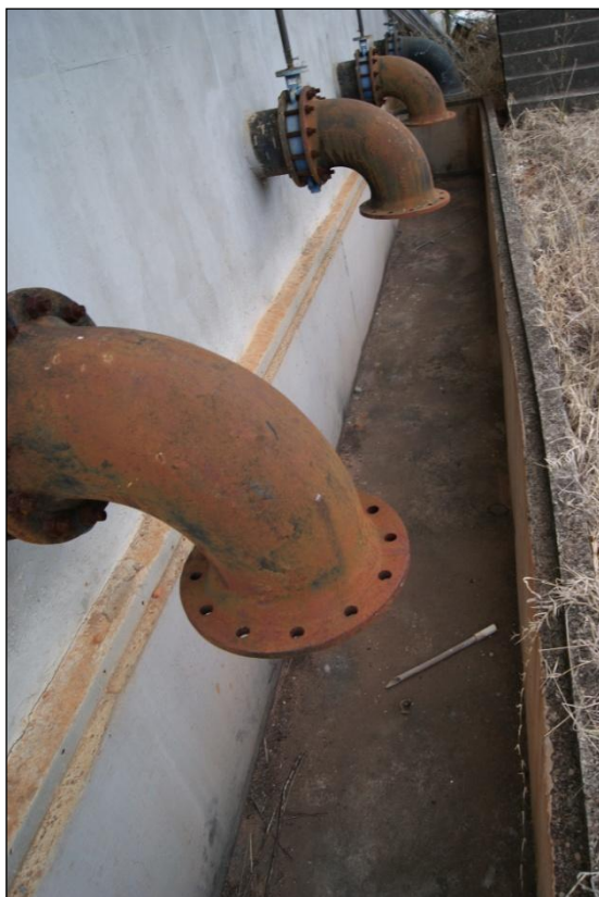
Foto 14: Parte das conexões existentes.
