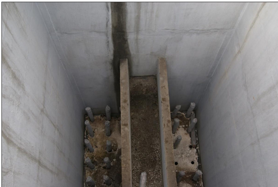
Foto 15: Parte do Filtro da ETA.
