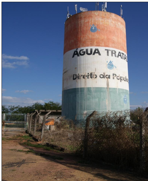
Foto 10: Reservatório localizado no bairro Jardim das Tulipas. Fonte: Contatto Environmental Engenharia e Consultoria Ltda.
