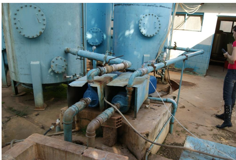
Foto 4: Bombas de recalque da água para tratamento. Fonte: Contatto Environmental Engenharia e Consultoria Ltda, 2013.
